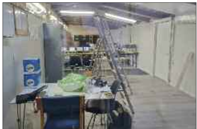
Før og under rigging, samt start isolering tak, søndag 19. november 2023. Foto: Håvard Larsen.
